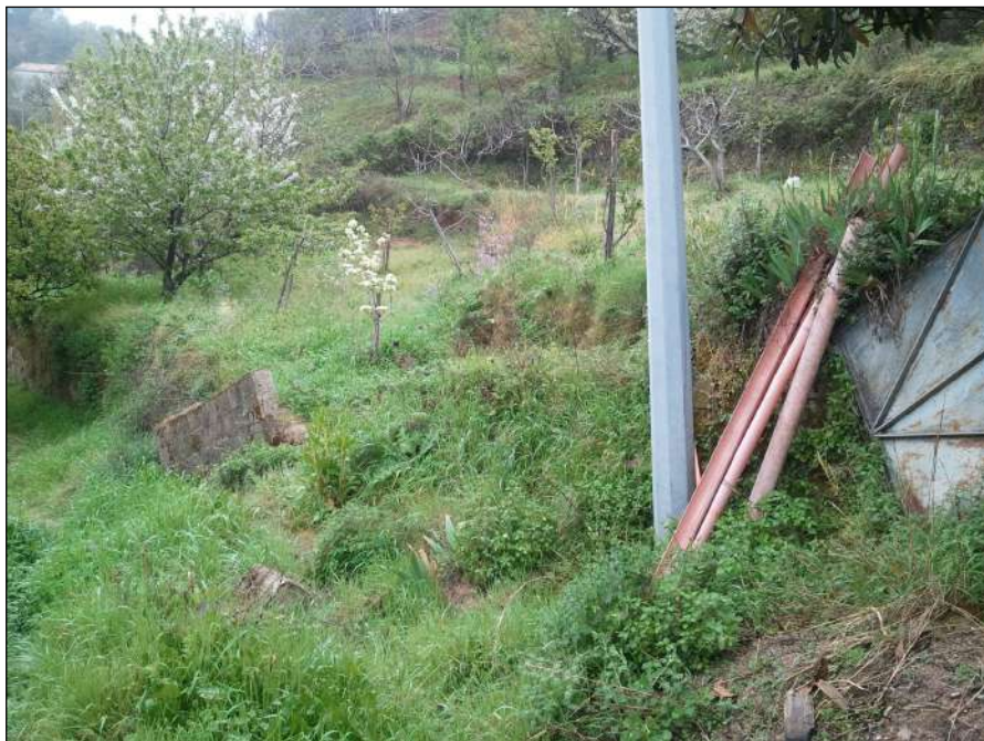
Foto 18: Lesioni e crepe in corrispondenza della zona di monte della precedente frana
